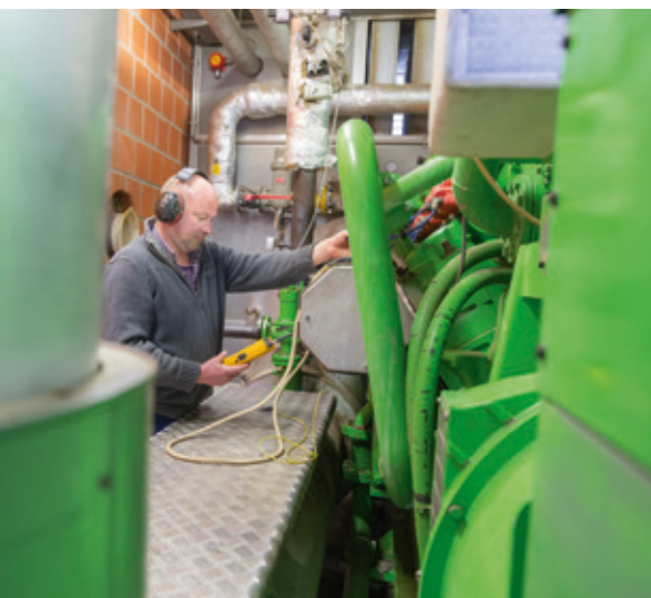
Biogasanlage: Wartung und Instandhaltung gehören zur täglichen Arbeit.
